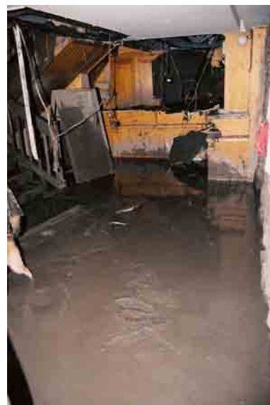
Les dégâts au niveau inférieur
