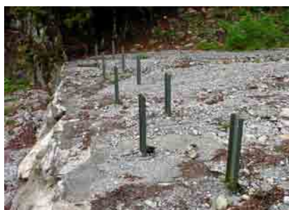
Photo 2.22 : Piège à flottants - Eaux Bonnes
