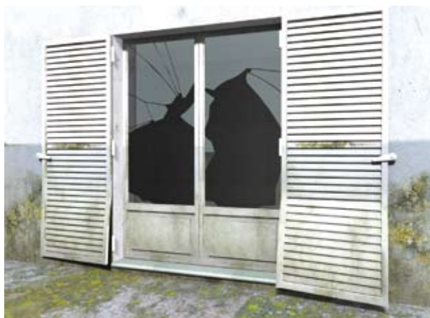
Dégradation d'une porte fenêtre.
