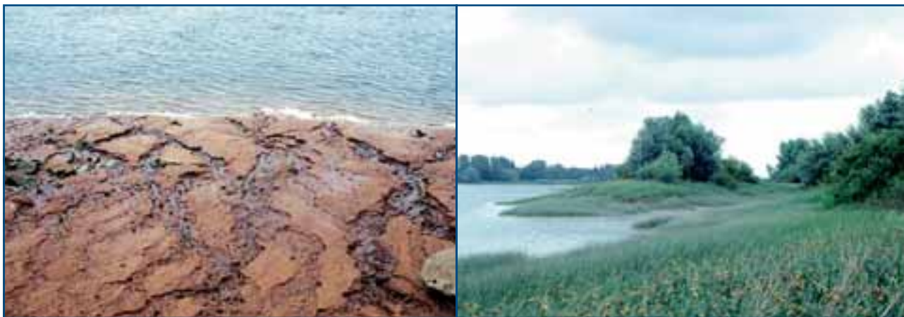
Figure 48 : Exemple d'érosion en berge sableuse de Loire marnante en amont de Nantes, Ile Lorideau lors du reflux de la marée et étalement naturel de la végétation sur berge. ≡
