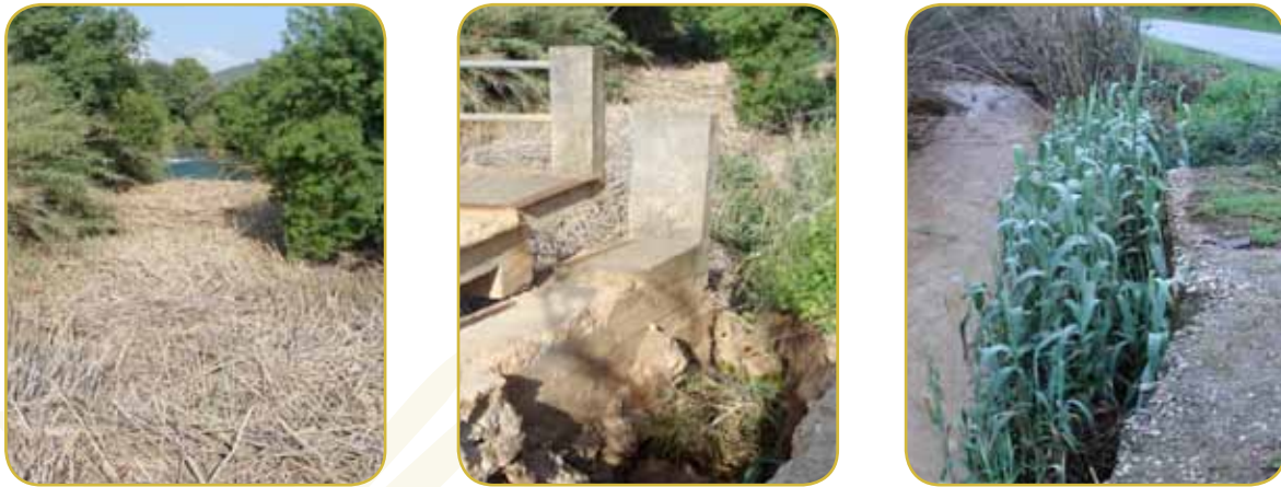
Figura 4. Masa de cañas arrastradas por corriente de ribera, Algarve, en riadas ocurridas en 2010 (izquierda), puente afectado por la presión ejercida (centro) y aspecto general en la línea de agua infestada por caña tras la riada (derecha).
