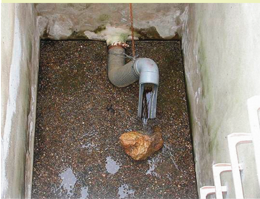
Figura 28.- Tubería de evacuación de efluentes, conectada a las tuberías de drenaje. Al ser flexible permite controlar el nivel del agua en el sustrato filtrante.
