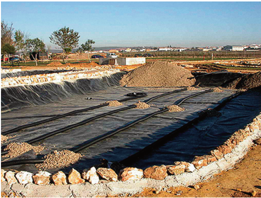
Figura 29.- Conjunto de tuberías de drenaje para la evacuación de los efluentes depurados en un HAFSs Vertical .
