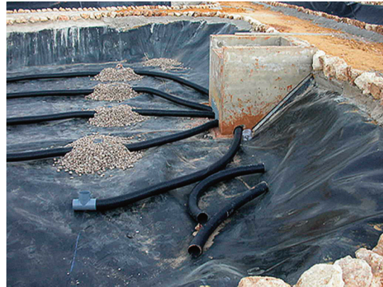
Figura 30.- Las tuberías de drenaje conducen los efluentes depurados hasta la arqueta de salida.
