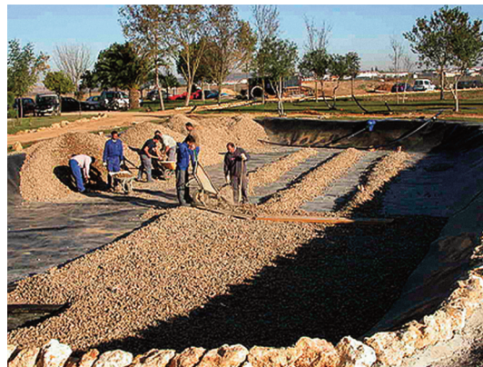
Figura 32.- La capa de grava que recubre a las tuberías de drenaje se extiende por todo el fondo del humedal.
