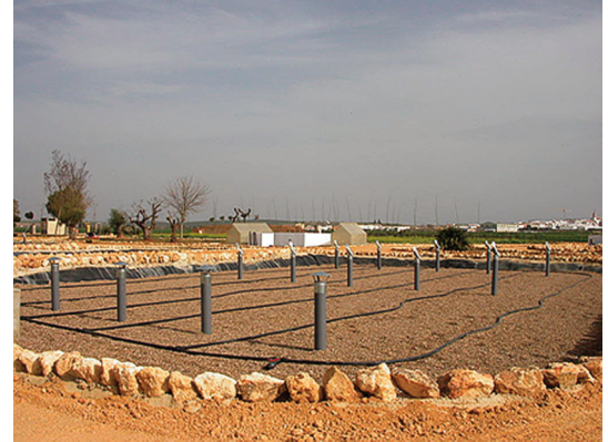
Figura 43.- Tuberías para el reparto de la alimentación en un HAFSS Vertical .
