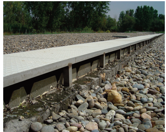
Figura 42.- Reparto de la alimentación a un HAFSs Horizontal mediante vertedero Thompson. (EDAR de Corbins, Lleida).
