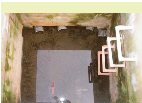
Figura 33.- Detalles de las tuberías de evacuación de efluentes en la arqueta de salida.
