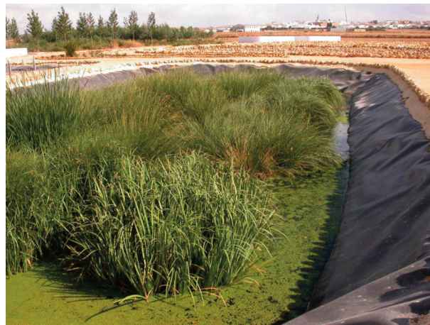
Figura 67.- Humedal Artificial de Flujo Superficial en la PECC.
