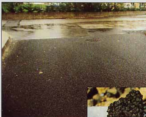
Jour de pluie : la chaussée poreuse au premier plan apparaît sèche alors que l'eau ruisselle sur la chaussée traditionnelle au second plan.
