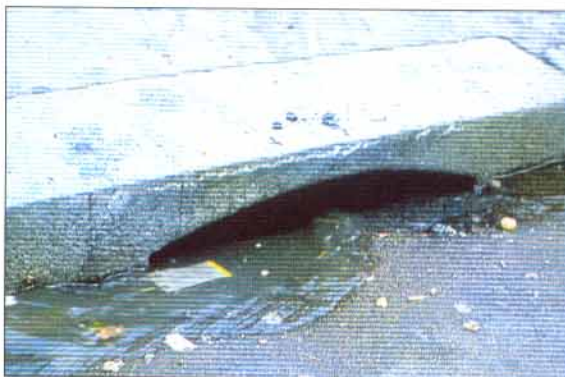
Les pluies produisent des eaux très sales...
